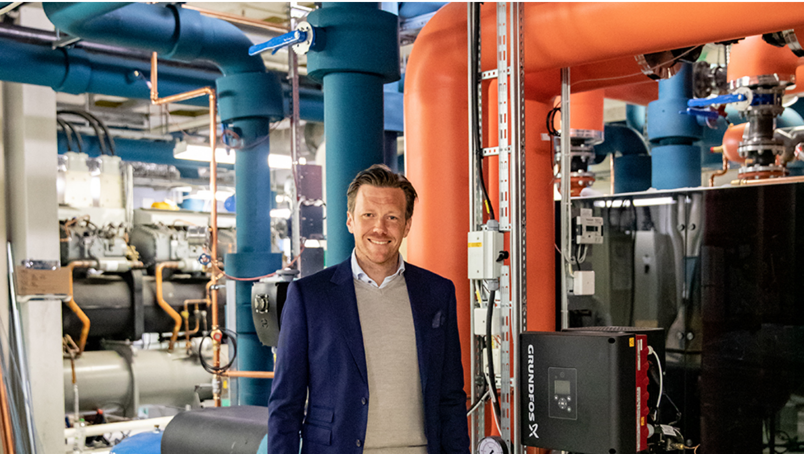
Henrik Pihlblad, teknisk chef på Frölunda Torg, visar upp energicentralen.
